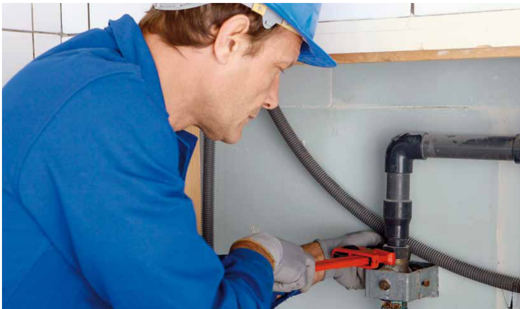
La durée de vie des conduites d'eau est en moyenne de 30 à 50 ans.
