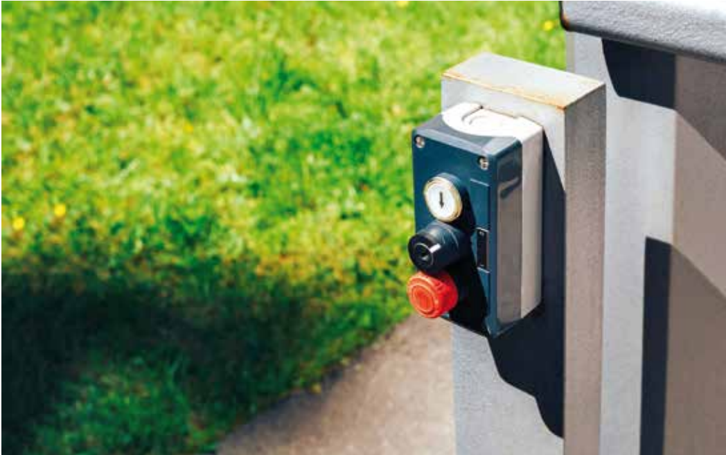
Télécommande pour l'ascenseur au premier étage.
