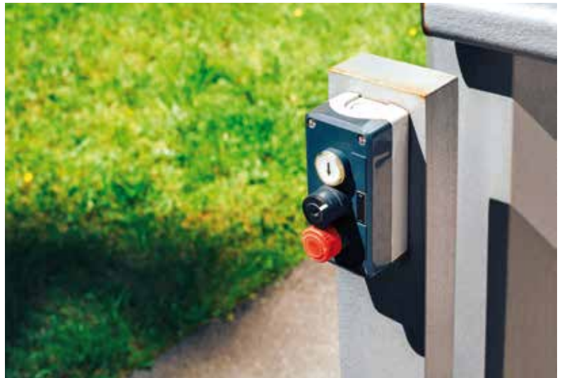
Fernbedienung für den Aufzug zum ersten Stock in einem Wohnhaus.
